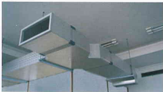
空調風管, 抗菌鍍鋅鋼板
